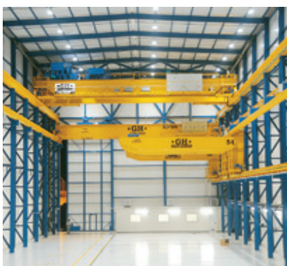
Pont roulant bipoutre et grue vélocipédique
