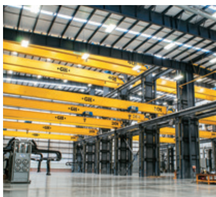
Pont roulant posé monopoutre
